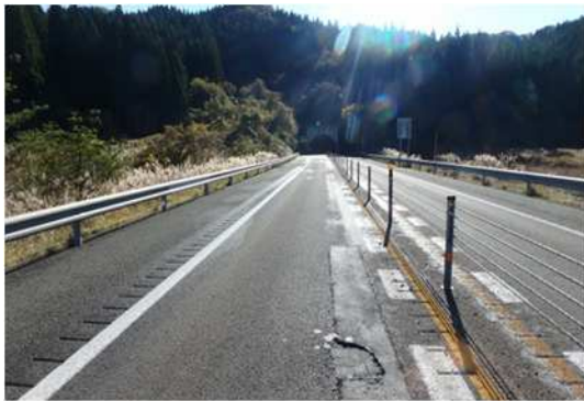
舗装損傷写真
