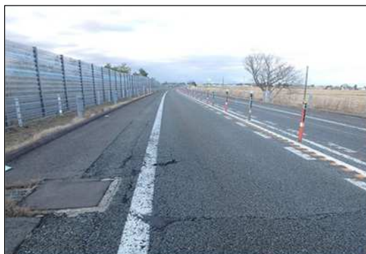
舗装損傷写真 ※応急補修済み
