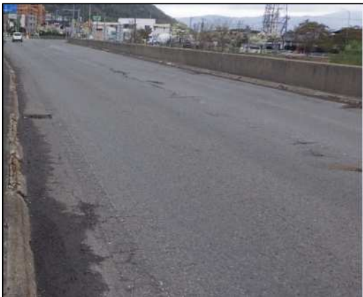
舗装損傷写真
