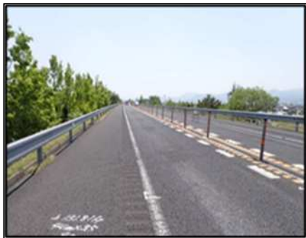
舗装損傷写真
