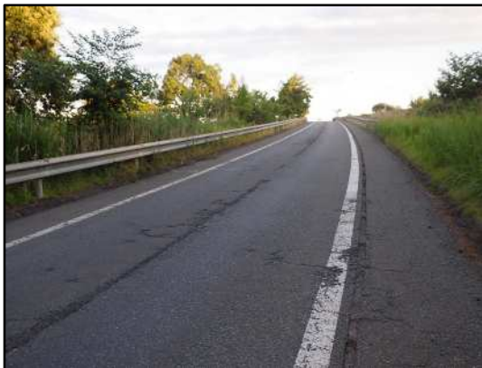
舗装損傷写真
