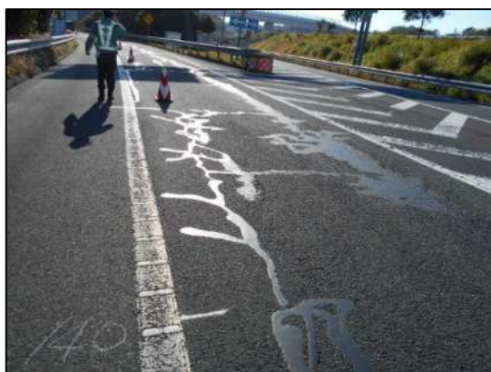
舗装損傷写真
