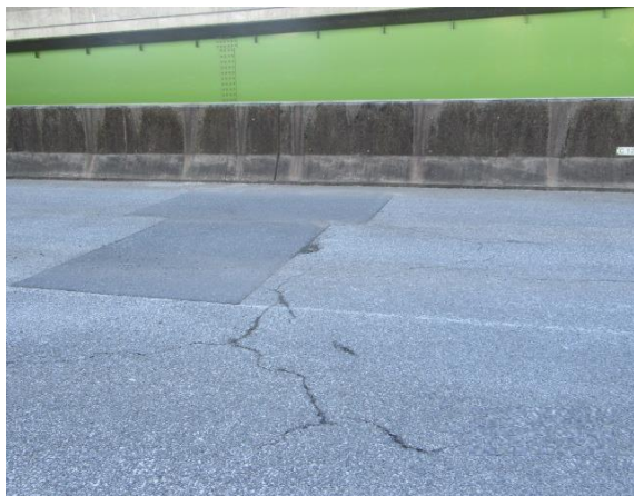
路面損傷状況
