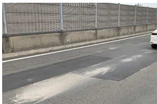
路面損傷状況
