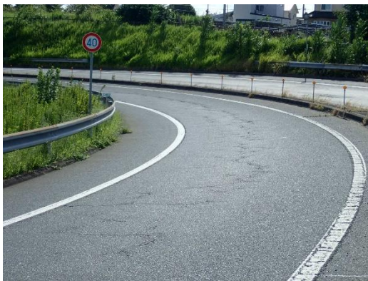
舗装損傷状況
