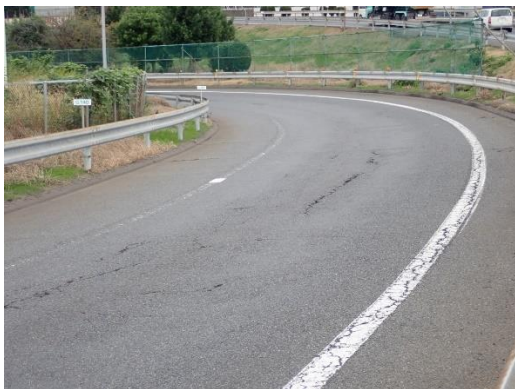
舗装損傷状況
