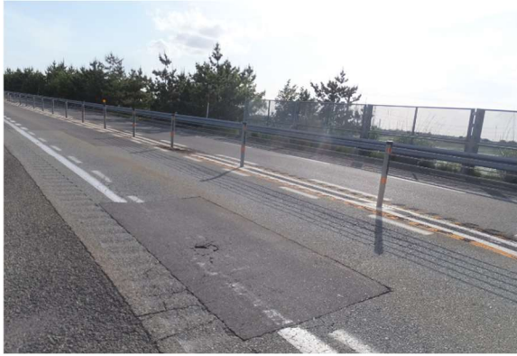
損傷した路面状況
