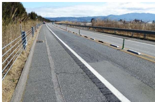
損傷した路面状況
