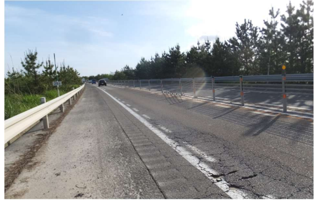
損傷した路面状況
