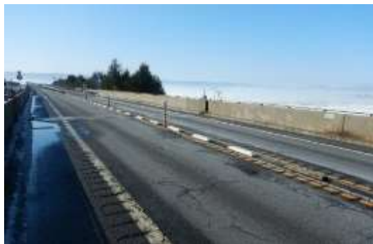
損傷した路面状況
