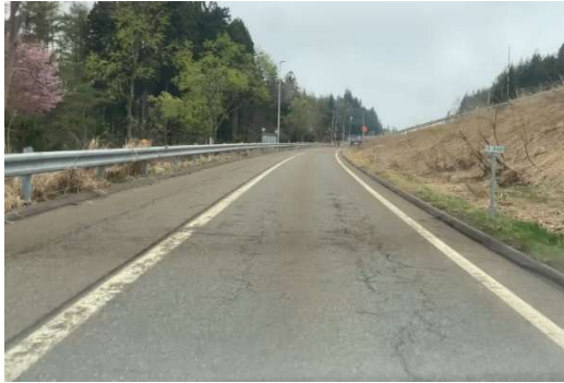
損傷した路面状況
