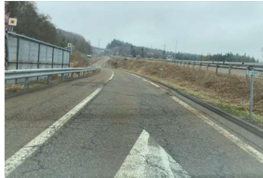
損傷した路面状況
