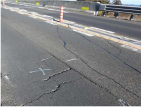
舗装損傷写真
