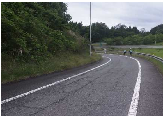
舗装損傷写真
