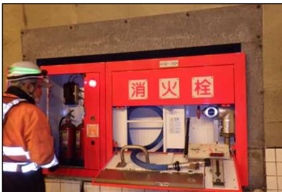
トンネル非常用設備点検
