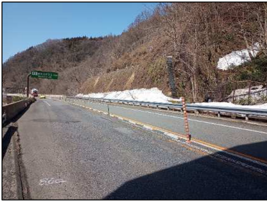
舗装損傷写真
