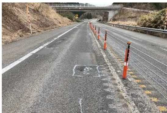
舗装損傷写真
