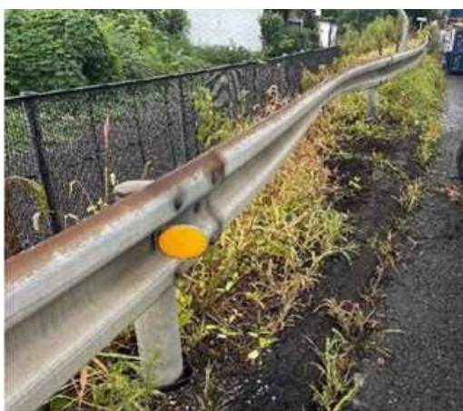
防護柵損傷写真
