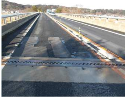
舗装損傷写真
