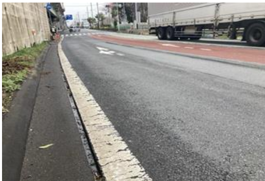
路面損傷状況
