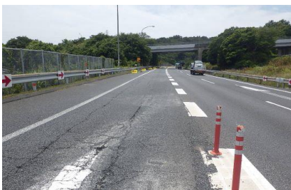
路面損傷状況
