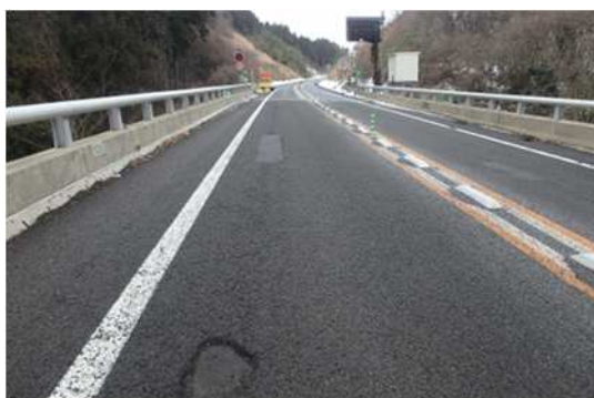
舗装損傷写真
