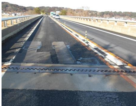
舗装損傷写真
