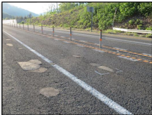
舗装損傷写真
