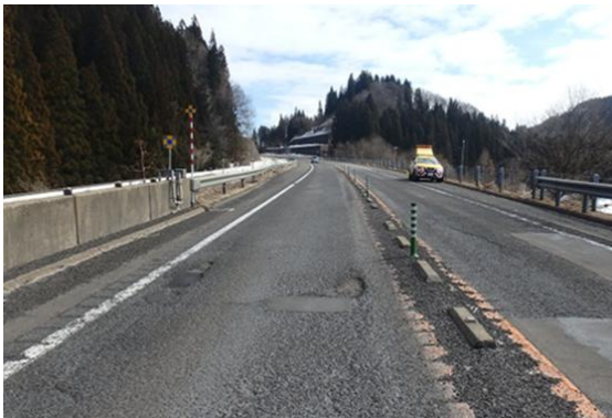
舗装損傷写真
