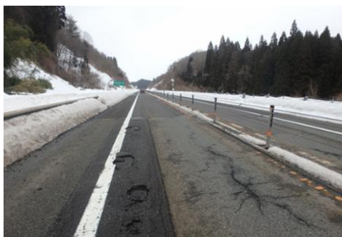
舗装損傷写真
