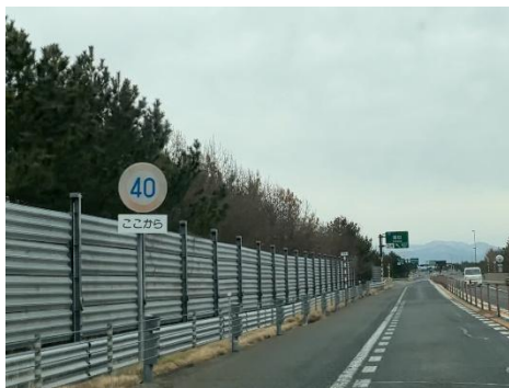
樹木繁茂写真
