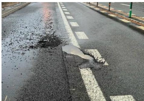
舗装損傷写真
