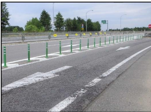
舗装損傷写真
