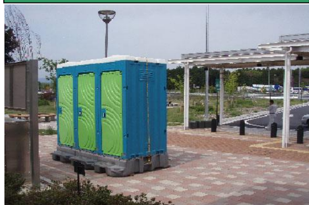
臨時トイレの設置
