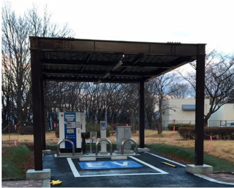
急速充電設備(東北自動車道 岩手山SA 上り線)
