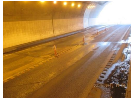
トンネル内の排水詰まり
