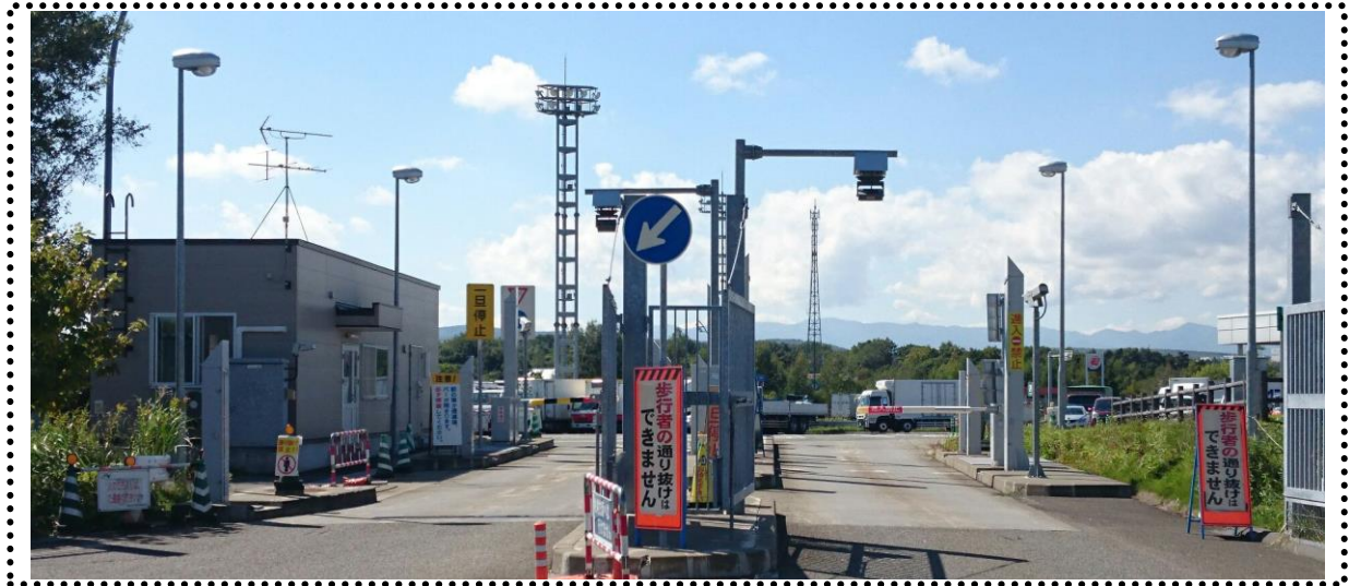
既設ETC設備
