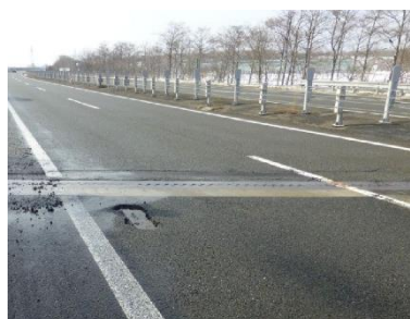
【路面の損傷発生状況(勇払川橋 上り線)】
