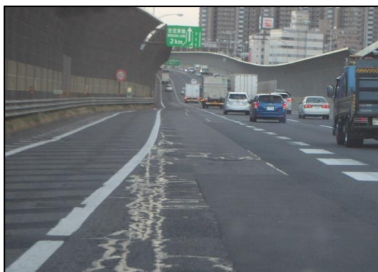
路面損傷状況
