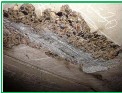
【コンクリート床版裏面の損傷状況(豊洲高架橋)】
