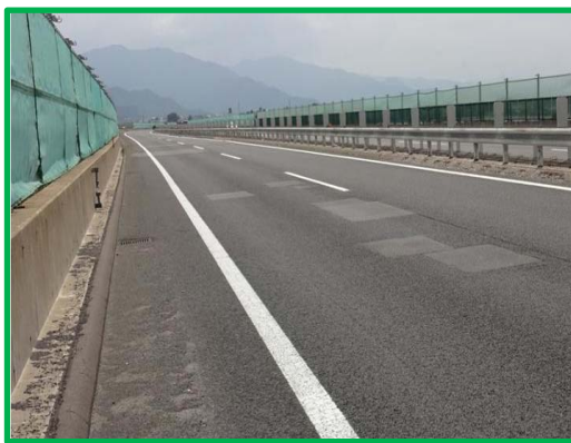
【舗装路面の損傷状況(豊洲高架橋)】
