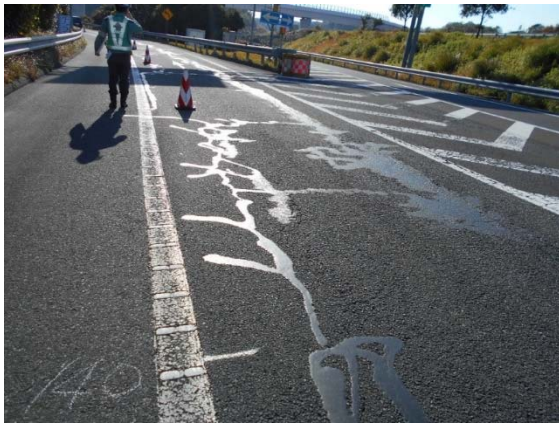
舗装損傷写真
