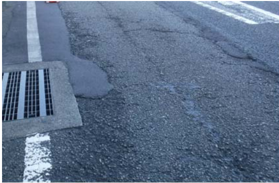
路面の損傷状況
