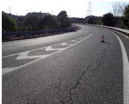
路面の損傷状況
