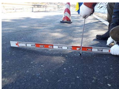
路面の損傷状況
