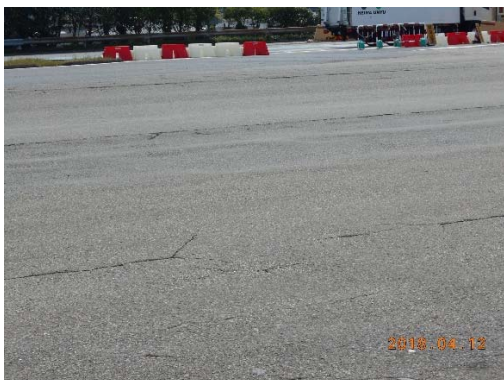
所沢IC 現況舗装状況
