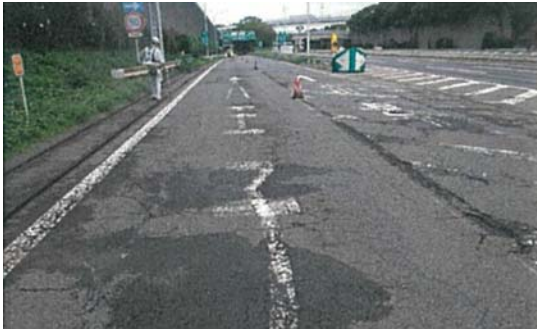
舗装損傷写真
