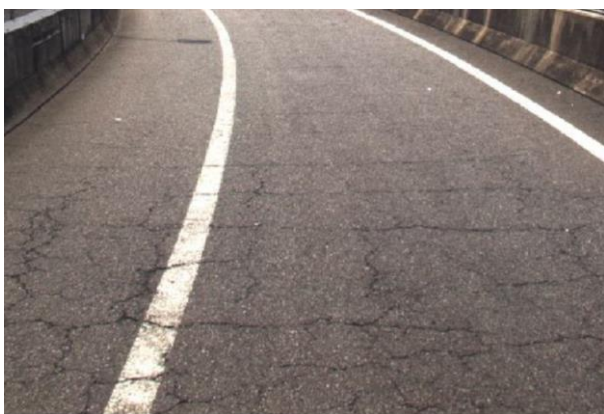
舗装損傷状況
