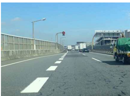
舗装損傷状況
