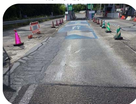
舗装損傷状況
