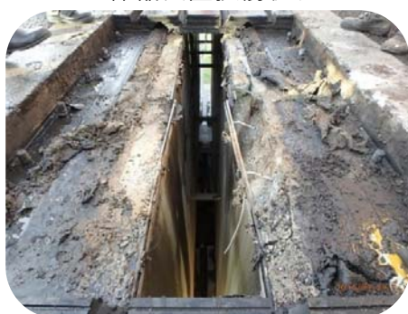
伸縮装置損傷状況
