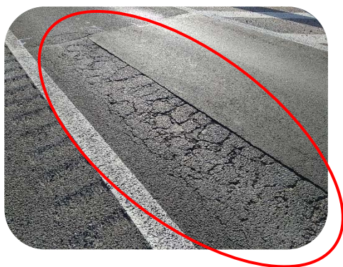
舗装損傷状況
