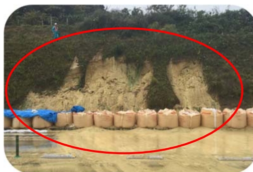
のり面災害状況
