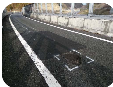
舗装損傷状況
