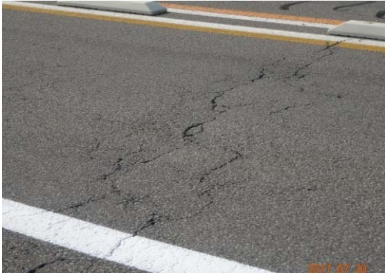
【路面損傷状況】
