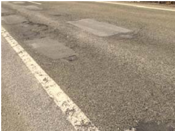
舗装の損傷状況図
