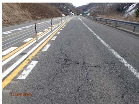
【路面損傷状況】
