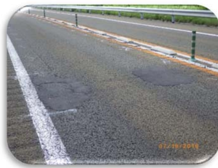
舗装損傷状況
