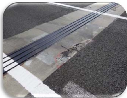
伸縮装置損傷状況
