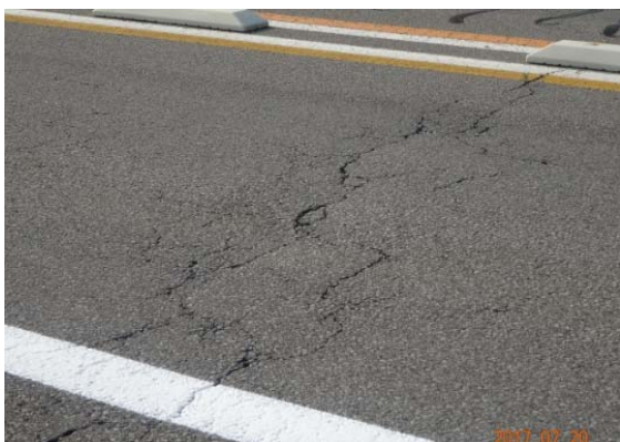
【路面損傷状況】
